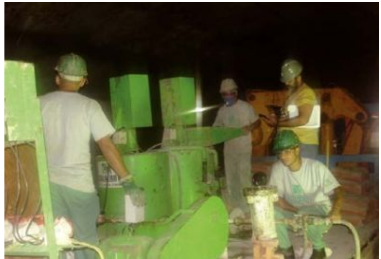
Consolidação de área adjacente a túnel metroviário - Brasília/DF Injeção de calda de cimento em área adjacente ao túnel.
