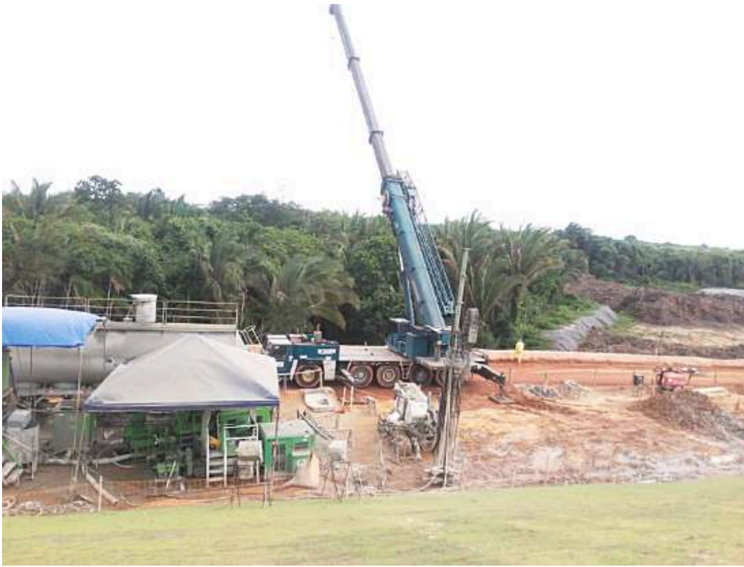
Execução de 120 colunas de 1,2 m de diâmetro, pela técnica de Jet Grouting - São Luís/MA
