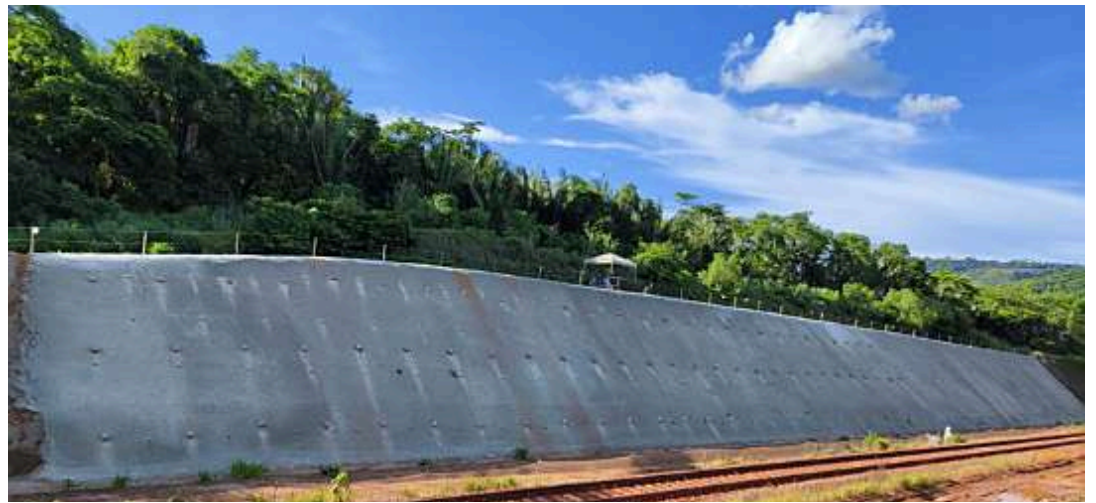
Recuperação de taludes lindeiros à ferrovia EFC por meio de solo grampeado com paramento em concreto projetado - Canaã dos Carajás/PA
